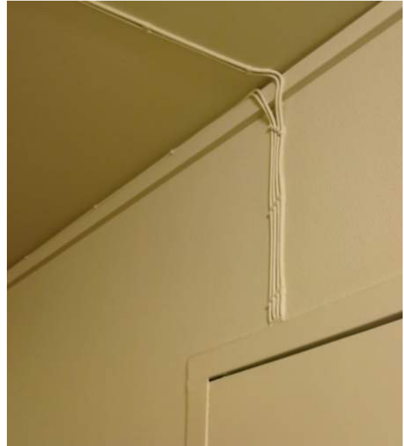
Elledningar saneras på alla plan, mer eller mindre stort behov. Utförs av elentreprenör.
