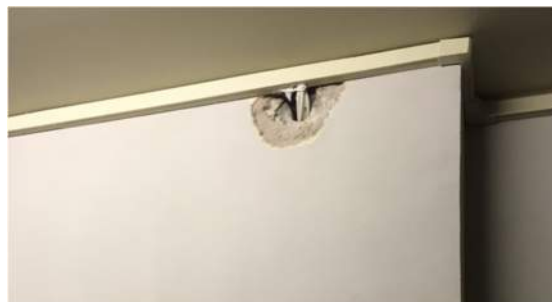
Vertikala el och fiberdragningar går i hisschaktet och har borrats ut den nya elkanalen vid tak. Ibland gick väggen sönder lite. Pga mycket hård betong kunde inte nya installationer bilas in i väggarna.
