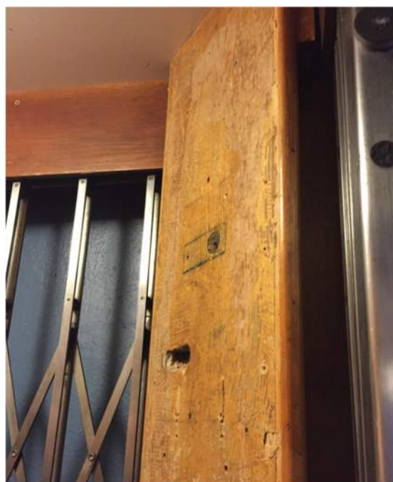
Den ursprungliga utformningen med rundade kanter framkom vid demontering, men var illa skadad.
