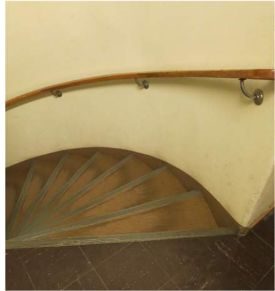
Sliten trappa med målad skursockel mot väggen, troligen från 1970-tal.
