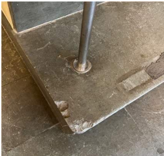
Skador i kalkstenen i utsatt trapphörn
