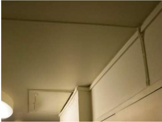
Elledningar till armaturer är olyckligt dragna tvärs korridoren. Taklisten mot tak innehåller bla data och telefonledningar.
