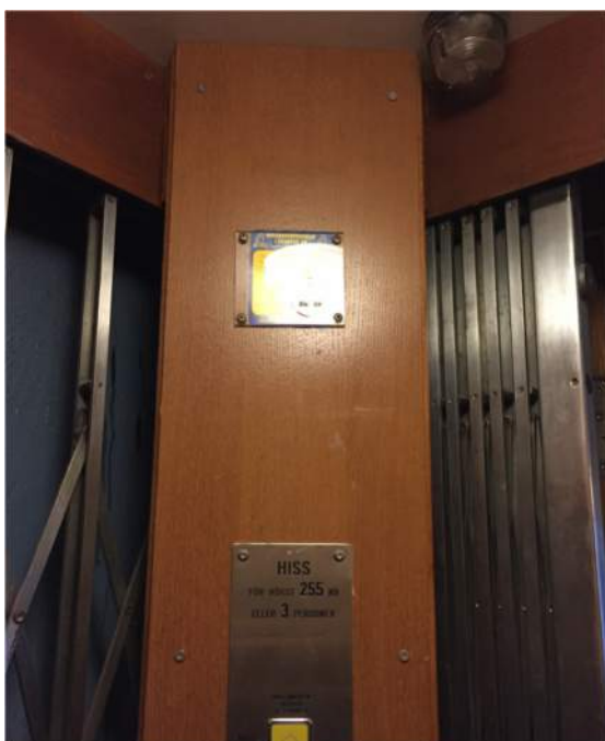
I samband med byte av hisstablån diskuteras återställande till ursprunglig kantdetalj på den diagonalställda skivan.
